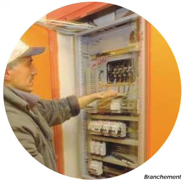
Branchement d'une armoire électrique (Médiathèque EDF - Jean-Christian Meyer)
