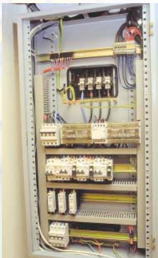
Armoire électrique (Médiathèque EDF - Jean-Christian Meyer)
