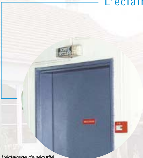
L'éclairage de sécurité dans un parking
